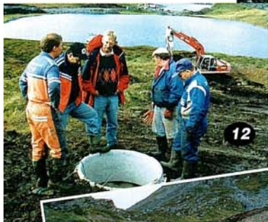
Bilde 12: Vegframføringa i Sarnesområdet medførte at flere hytteeiere fikk sin vannforsyning kuttet. Men vegvesenet ordnet opp ved å sette ned nye vannkummer og fikk strekt nye vannslanger slik at hyttefolkene fikk sitt daglige vann. Rundt kummen, Stål Pedersen, Per Kling Mathiesen, Steinar Nilssen, hytteeier Arne Jensen og maskinkjører Eilert Persen.
