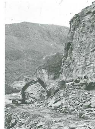
...og slik så det ut i juni etter at massene var ryddet bort. Skjæringen til høyre på bildet er opp til 36 meter høy.
