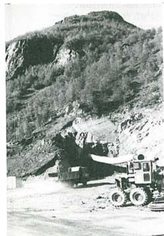
Dette er innslaget til Øksfjordtunnelen ved Storvik. Det er fra denne sida at problemene med dårlig fjell har dukket opp.
